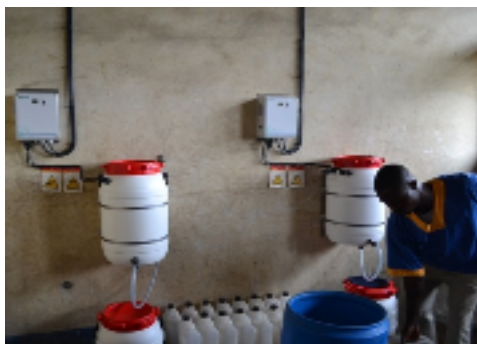
Local à production de chlore - Kinshasa (RDC)
