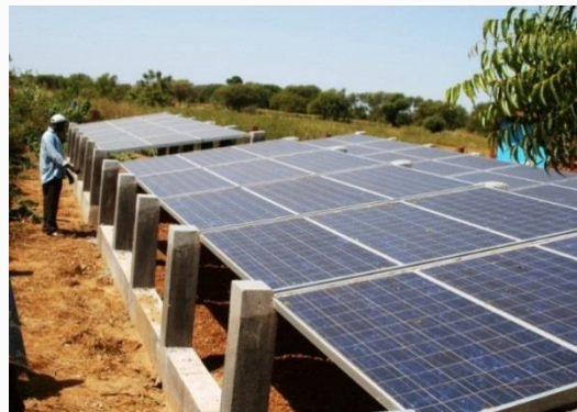
Projet solaire photovoltaïque PMRE14, République du Mali
